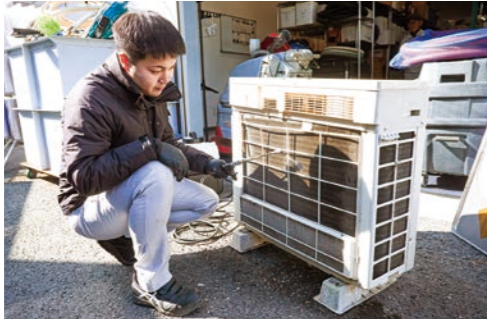
空調設備の洗浄・点検・修理に携わる社員は、電気工事士や冷凍機械責任者などの資格を持ち、実務に当たる。
