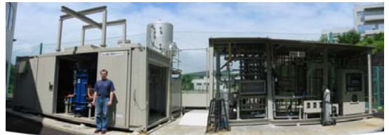
海水電解プラント CO2メタン化プラント
